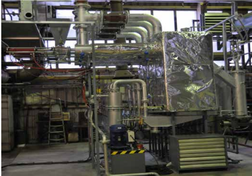
Рис. 1. Установка ОИВТ РАН по отработке режимных параметров технологии конверсии местных топливно-энергетических ресурсов в газовое топливо. Мощность – 50 кВт эл.
