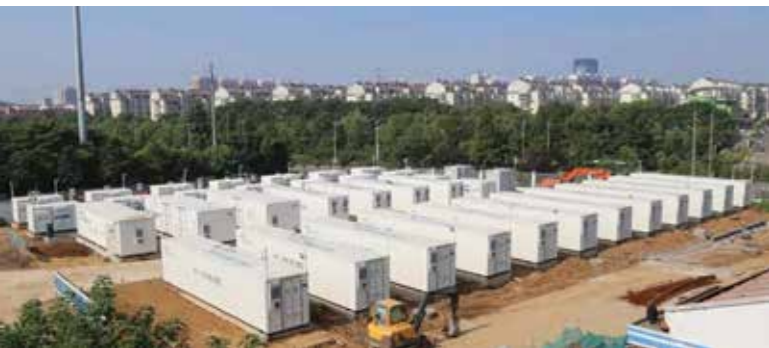
Рис. 2. Система накопления мощностью 100 МВт компании Zhongtian Yipin Technology
